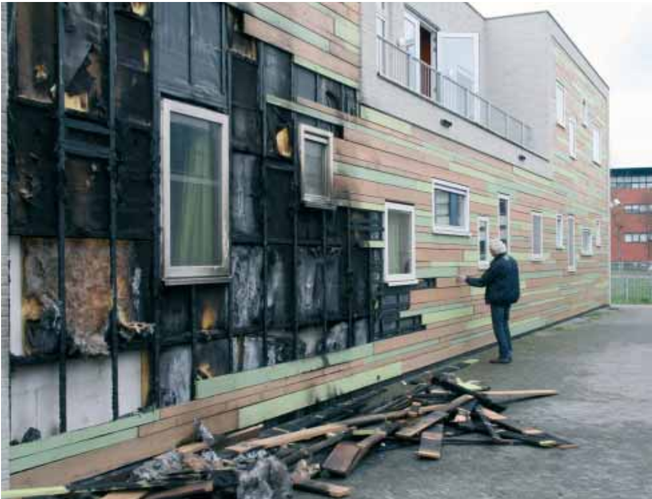
Een expert was direct aanwezig met het opnemen van de schade
